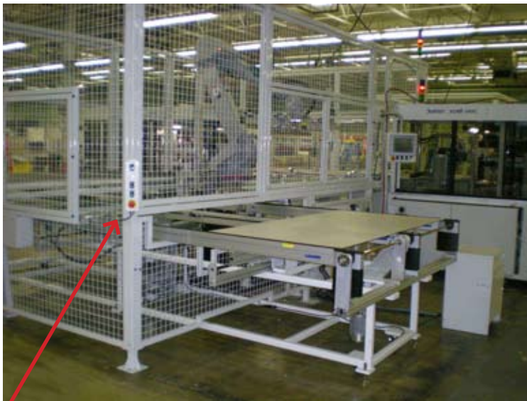
Figura 3.3.3 - Botones de paro de emergencia
